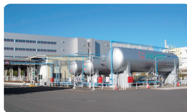
LPガス充てん施設
