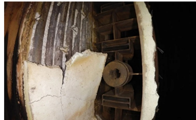
撮影したボイラー内部の破損
