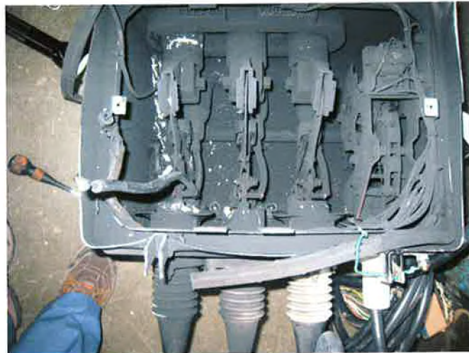
図 5. 区分開閉器の2次側U相V相ブッシング破損 VT 及び LA リード線溶断
