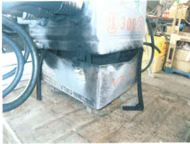
図 4. 破損した区分開閉器
