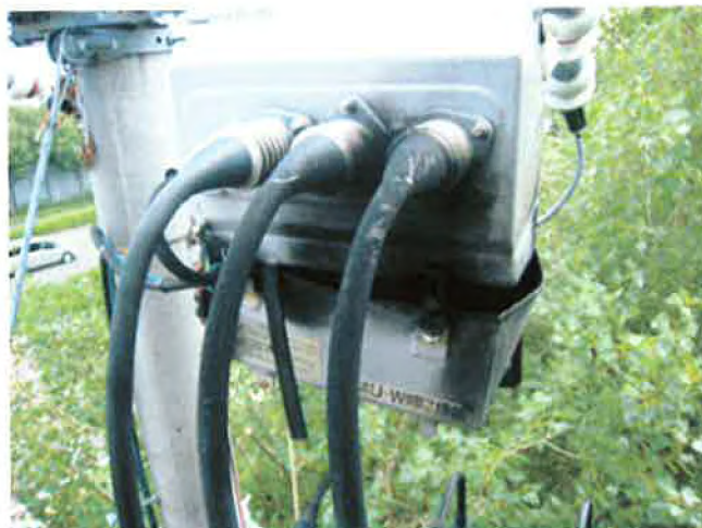
図3. 受電柱上の区分閉器の破損状況
