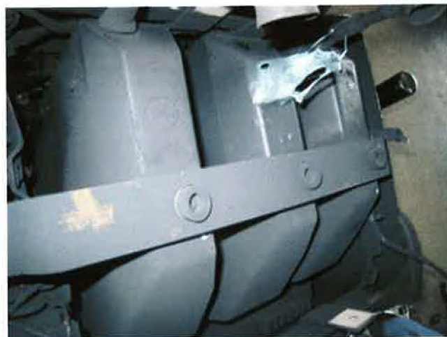
図 6. 区分開閉器内の VT が焼損しバリアが溶けて穴があいた
