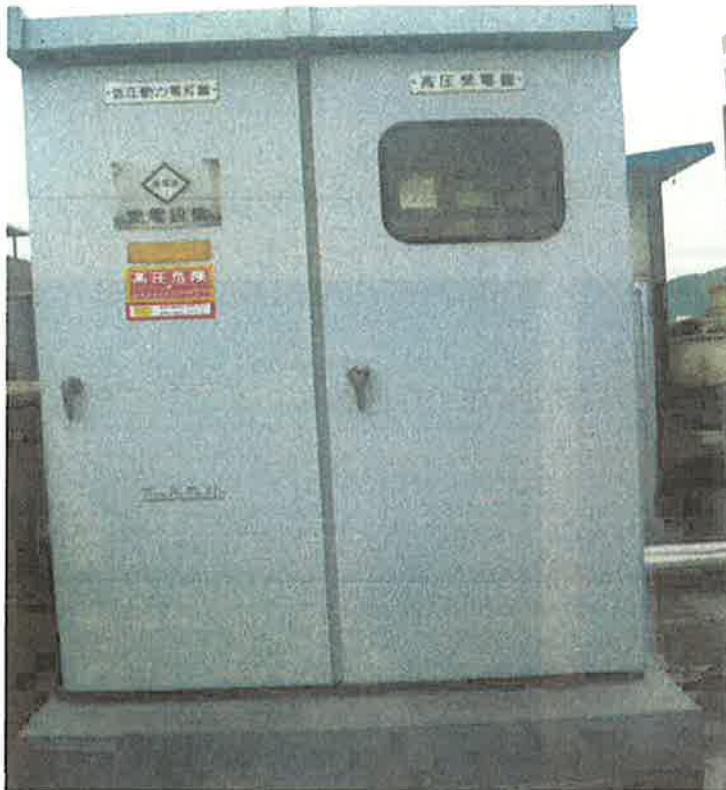
高圧キュービクル外観
