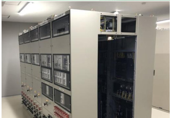
187kV母線保護Ry
