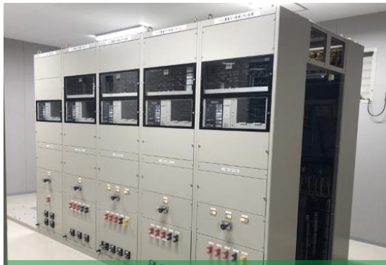
187kV送電線保護Ry
