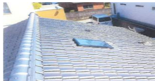
屋根上に飛散したモジュール
