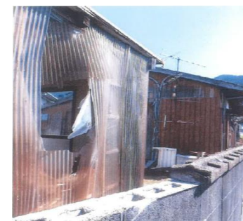
破損した民家
