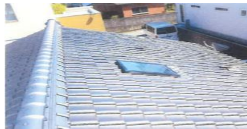
屋根上に飛散したモジュール
