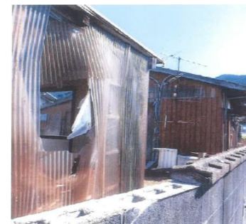
破損した民家
