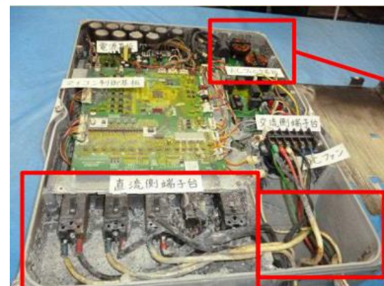
PCSの焼損事故の例
