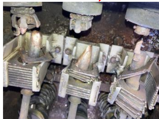
③一次側固定接触部の破損状態
