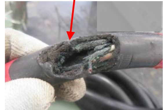
損傷箇所拡大
