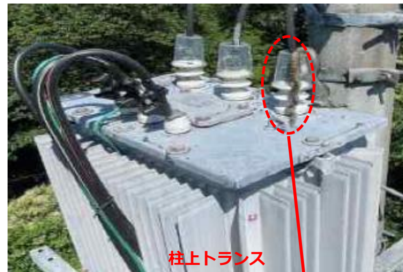
柱上トランス 地絡事故発生時の状況
