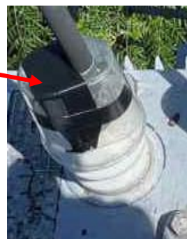
カバーの隙間を閉塞 （応急対策）
