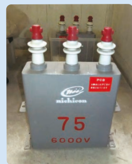
電力用コンデンサー
