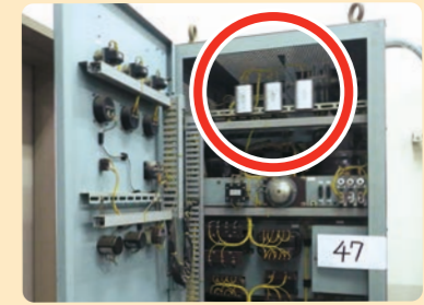
可変周波数電源装置に取り付けられた低圧コンデンサー
