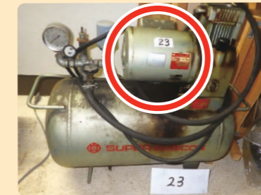
コンプレッサーに取り付けられた低圧コンデンサー
