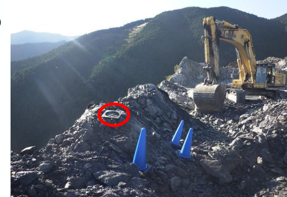
罹災者転落推定箇所
