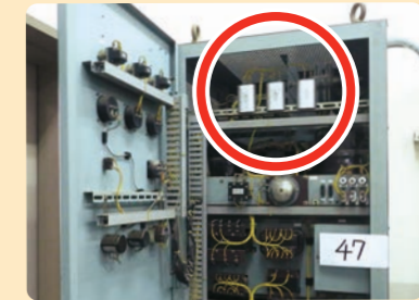
可変周波数電源装置に取り付けられた低圧コンデンサー
