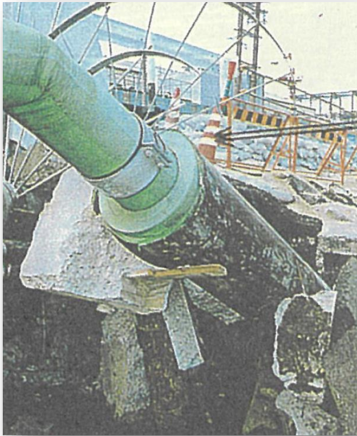
▲崩壊した架橋護岸部の中圧ガス管 ：ガス漏れなし
