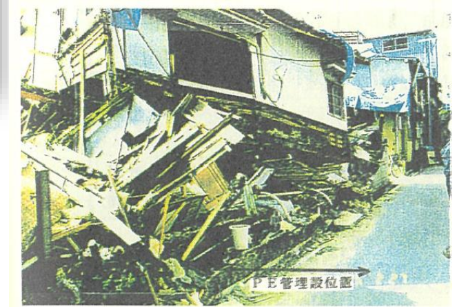
▲激しい家屋被害があったが ポリエチレン管は被害なし
